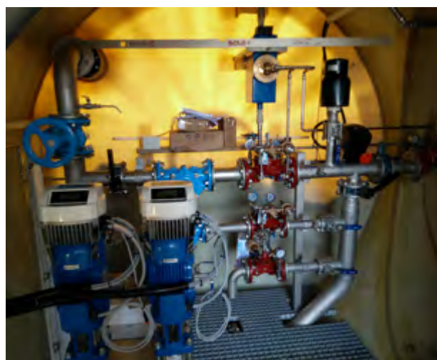
In den Jahren 2016/17 wurde beim Pfarrhof ein neuer Behälter errichtet. Er enthält mit einem Pumpwerk ebenfalls ein sehr komplexes Innenleben, das nur ausgewiesene Fachleute betreuen können. Wassermeister Harald Marte ist mit den modernsten Anlagen jedoch bestens vertraut. Alle Fotos: Wassergenossenschaft Dafins, Mario Rogen
